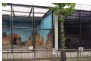
(猛兽舎の檻の破損)
