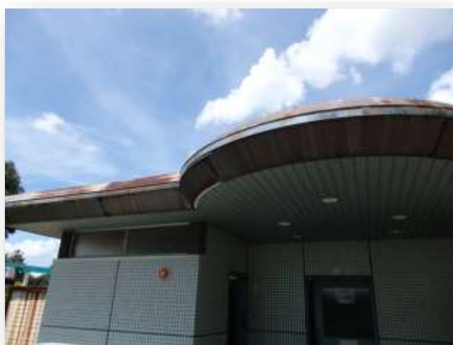
(写真上) 鋼板が錆ついている屋外トイレ
